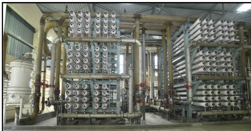
Fig. 12 RO Membrane Modules at 35 MLD capacity TTP, Bamroli
