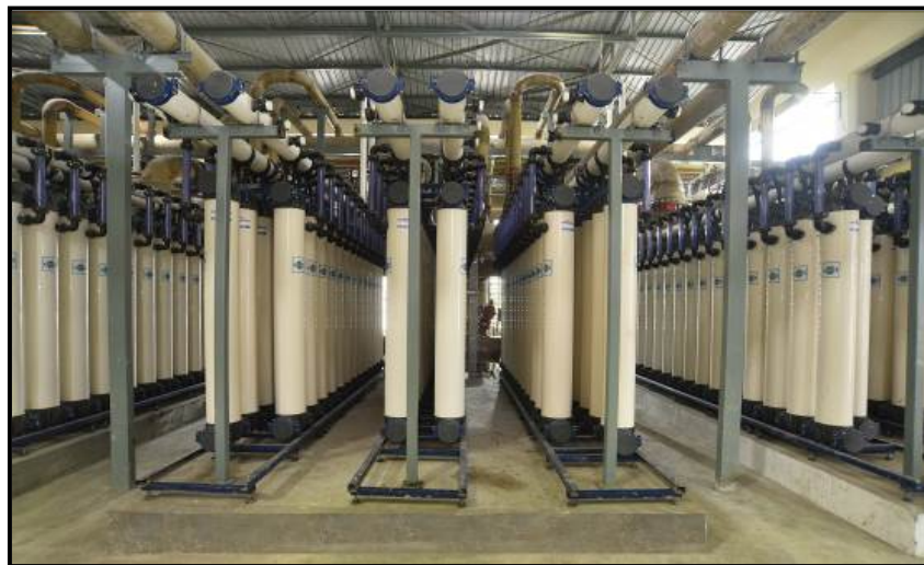
Fig.11 UF Membrane Modules at 35 MLD capacity TTP, Bamroli
